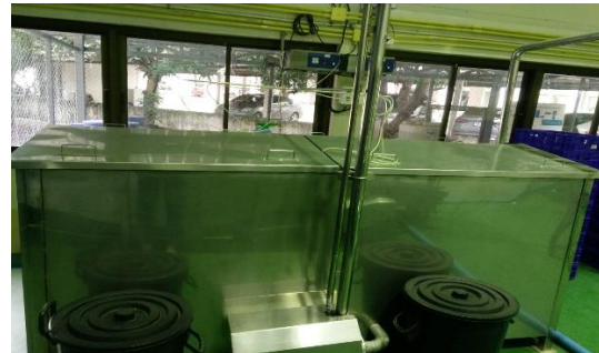
ง. เครื่องทำน้ำเย็นชนิดระบายความร้อนด้วยอากาศ
